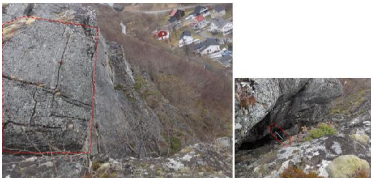
Figur 27 Lokaltet 5 a) - bildet til høyre viser metallstang installert i sprekk (mulig utstyr for å måle eventuell bevegelse?), se også Figur og Figur 28).
